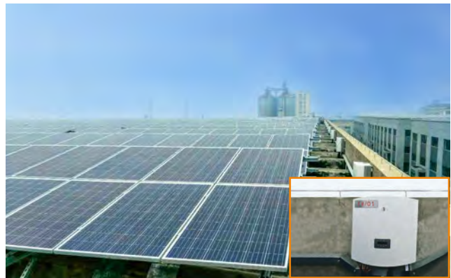
Changzhou Vaillant 2MW
