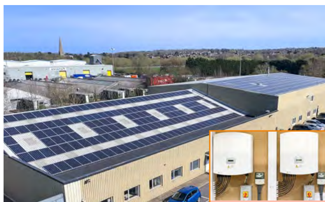
Grundfos Rooftop, UK 123.4kW
